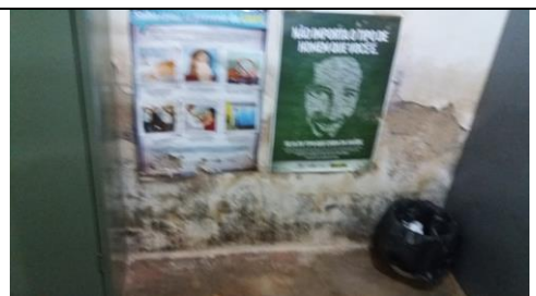
Foto 03 – Farmácia Municipal – Parede mofadas, com infiltração – Local de armazenamento de medicamentos controlados - Data: 09/10/2018
