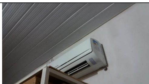
Foto 19 – Ar condicionado com capacidade inadequada permitindo a formação de zona de calor – Farmácia Municipal - Data: 09/10/2018
