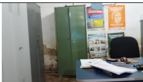
Foto 06 – Detalhes do Armazenamento – Armários com medicação controlada próximo de paredes deterioradas – Farmácia Municipal - Data: 09/10/2018
