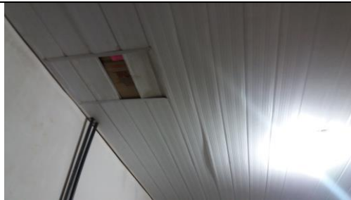
Foto 10 – Forro em péssimo estado de conservação – Farmácia Municipal - Data: 09/10/2018
