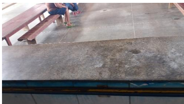
Foto 49 - Bancada da janela da cozinha acumula sujeira, contrariando o item 4.1.4 e 4.2.1 da Resolução-RDC Anvisa 216/2004 Data 27/09/2017
