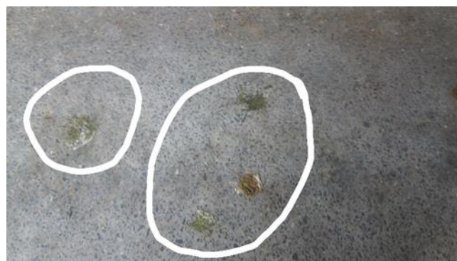
Foto 75 - Fezes de pombos no piso do refeitório, contrariando o Item 4.1.7 da Resolução-RDC Anvisa 216/2004. - Data: 18/12/2017
