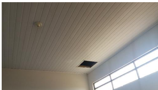
Foto 19 - Abertura no Forro, Permitindo a Entrada de insetos e roedores., acúmulo de sujeira, contrariando o item 4.1.3 da Resolução-RDC Anvisa 216/2004 - Data: 22/09/2017
