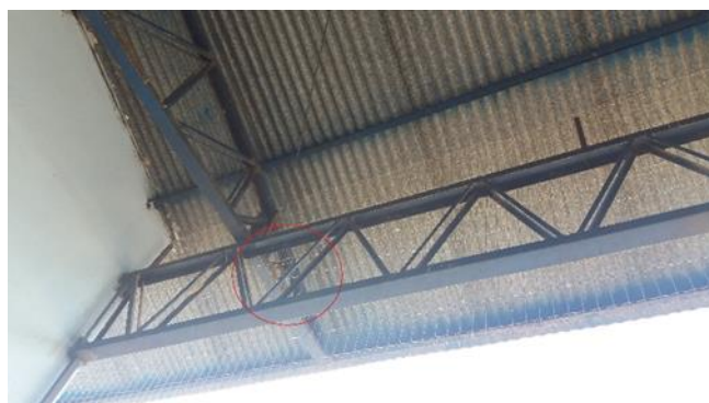
Foto 57 - Presença de pombos na cobertura do refeitório fonte de possíveis contaminações. Data: 22/09/2017
