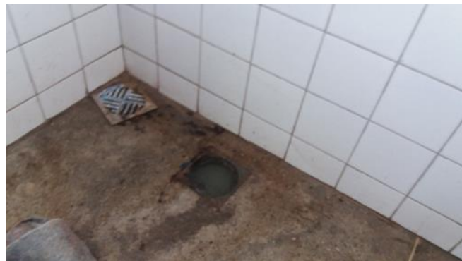
Foto 28 - Ambiente localizado do lado da cozinha e de frente para o refeitório - Fonte de Contaminação, em desacordo com os itens 4.1.6 e 4.1.7 da Resolução-RDC Anvisa 216/2004 Data: 22/09/2017
