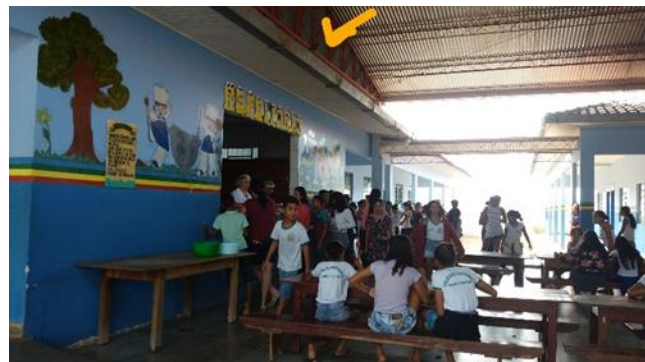
Foto 67 - Bombo presente acima da janela onde é servida a merenda, contrariando o Item 4.1.7 da Resolução-RDC Anvisa 216/2004. - Data: 27/09/2017
