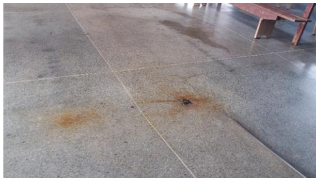
Foto 66 - Péssimo estado de conservação do piso do refeitório, sujeiras e sinais de vazamentos de chuva – Data: 27/09/2017
