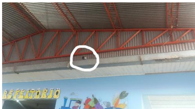
Foto 72 - Pombo hospedado acima da janela do refeitório e da Cozinha, contrariando o Item 4.1.7 da Resolução-RDC Anvisa 216/2004. - Data: 18/12/2017
