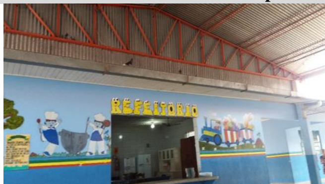
Foto 62 - Pombos hospedados acima da janela da cozinha e dentro do refeitório, contrariando o Item 4.1.7 da Resolução-RDC Anvisa 216/2004. - Data: 27/09/2017
