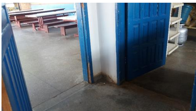
Foto 23 - Ausência de tela milimétrica de proteção na porta possibilitando a entrada de insetos e ausência de sistema de fechamento automático, contrariando o Item 4.1.4 da Resolução-RDC Anvisa 216/2004 Data: 22/09/2017
