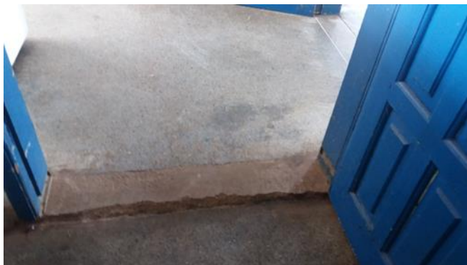
Foto 21 - Defeito no piso da cozinha e armazém possibilita acumular sujeira e acarretar acidente, acúmulo de sujeira, contrariando o item 4.1.3 e 4.1.4 da Resolução-RDC Anvisa 216/2004 Data: 22/09/2017
