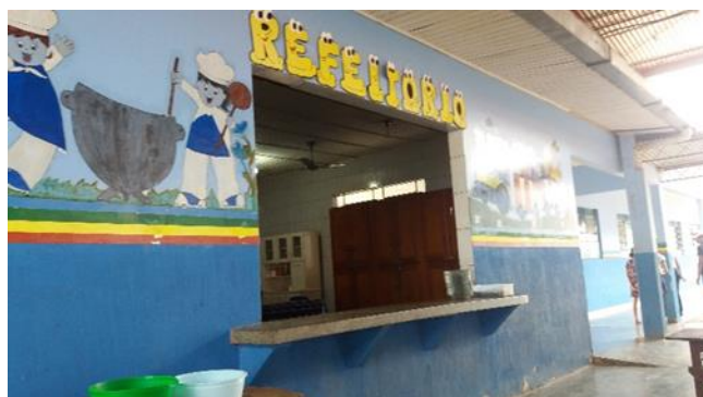
Foto 47 - Janela da cozinha sem tela milimétrica de proteção possibilitando a entrada de insetos, contrariando o item 4.1.4 da Resolução-RDC Anvisa 216/2004 - Data 27/09/2017
