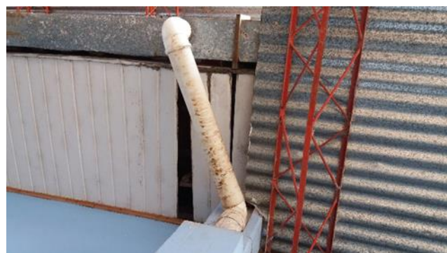
Foto 65 - Péssimo estado de conservação do forro do Refeitório, contrariando o Item 4.1.3 da Resolução-RDC Anvisa 216/2004. - Data: 27/09/2017
