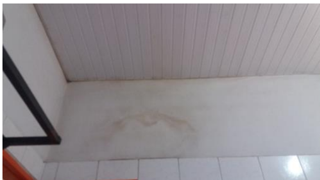
Foto 43 - Manchas na parede indicando infiltração, parede sem revestimento, contrariando o item 4.1.3 da Resolução-RDC Anvisa 216/2004 - Data 27/09/2017
