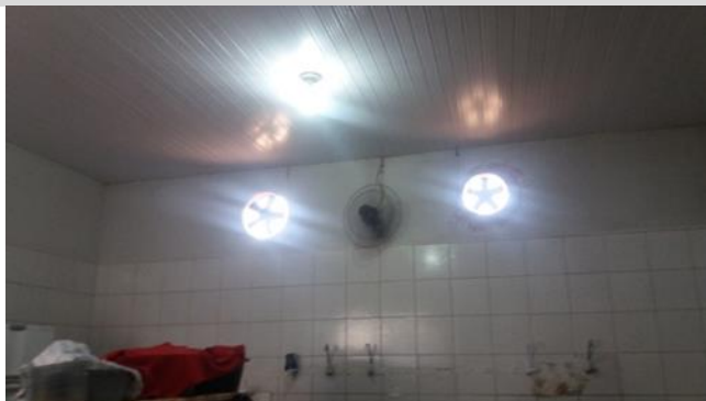
Foto 39 - Exaustores com defeito e ausência de tela milimétrica, contrariando os itens 4.1.4, 4.1.10 e 4.1.11 da Resolução-RDC Anvisa 216/2004 – Data 27/09/2017
