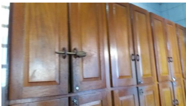
Foto 09 - Armário utilizado para armazenar alimentos, não há circulação de ar, contraria o item 4.7.6 da Resolução-RDC Anvisa 216/2004 - Data 27/09/2017
