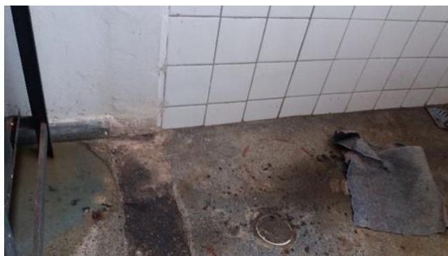
Foto 27 - Ambiente localizado do lado da cozinha e de frente para o refeitório - Fonte de Contaminação, em desacordo com os itens 4.1.6 e 4.1.7 da Resolução-RDC Anvisa 216/2004 Data: 22/09/2017
