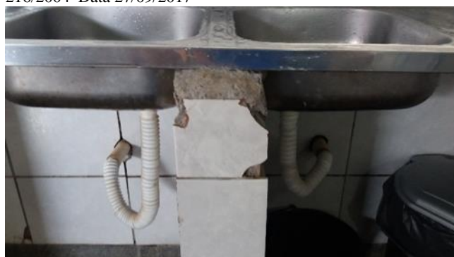
Foto 48 - Bancada da pia sem acabamento adequado permitindo acumular sujeira, contrariando o item 4.1.17 da Resolução-RDC Anvisa 216/2004. Data 27/09/2017
