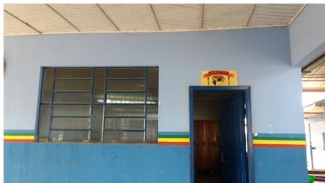
Foto 46 - Porta da cozinha sem tela milimétrica de proteção possibilitando a entrada de inseto, e sem sistema de fechamento automático, contrariando o item 4.1.4 da Resolução-RDC Anvisa 216/2004 Data 27/09/2017
