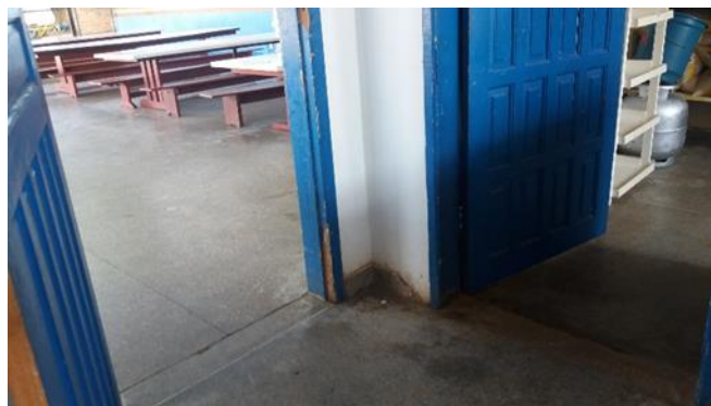
Foto 20 - Portal com defeito, e cantos que permitem acumular Sujeira, acúmulo de sujeira, contrariando o item 4.1.3 e 4.1.4 da Resolução-RDC Anvisa 216/2004 Data: 22/09/2017
