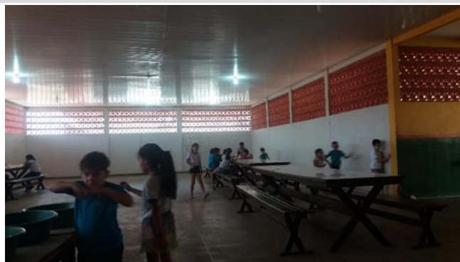
Foto 58 - Iluminação inadequada no refeitório Data: 27/09/2017
