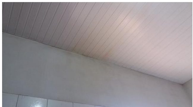
Foto 44 - Sujeira no foro indicando possível vazamento no telhado, contrariando o item 4.1.3 da Resolução-RDC Anvisa 216/2004 - Data 27/09/2017
