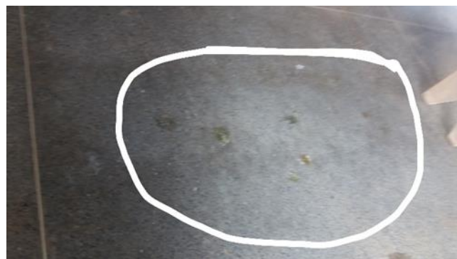
Foto 73 - Fezes de pombo no piso do refeitório, contrariando o Item 4.1.7 da Resolução-RDC Anvisa 216/2004. - Data: 18/12/2017
