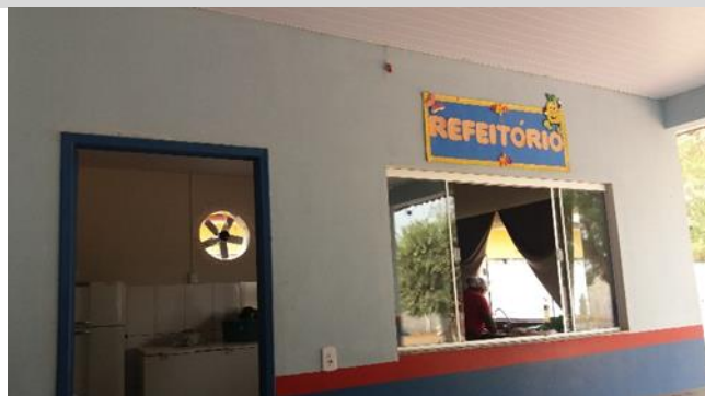
Foto 31 - Porta e Janela sem telas milimétricas de proteção possibilitando a entrada de insetos, contrariando o Item 4.1.4 da Resolução-RDC Anvisa 216/2004 – Data: 25/09/2017
