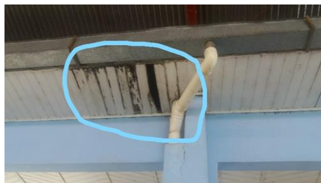
Foto 77 - Estado de conservação do forro do refeitório da contrariando o Item 4.1.3 da Resolução-RDC Anvisa 216/2004. - Data: 18/12/2017
