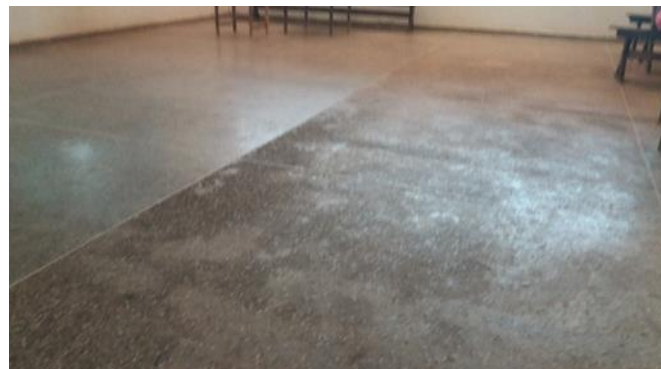
Foto 61 - Piso do refeitório em péssimo estado de conservação. Data: 27/09/2017
