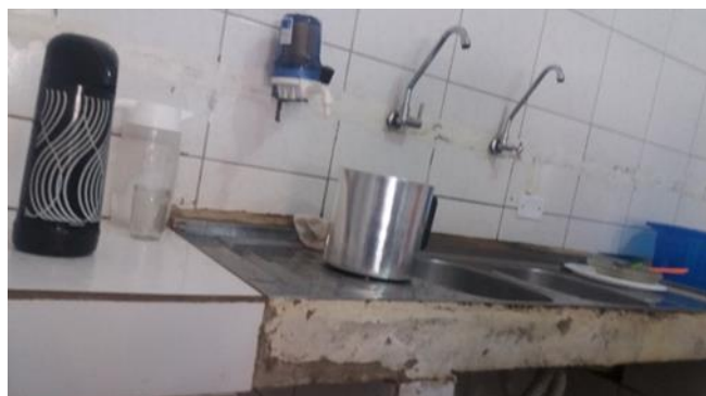
Foto 42 - Pia e parede com defeitos - possibilitando juntar sujeira – fonte de contaminação . contrariando o item 4.1.3 da Resolução-RDC Anvisa 216/2004 - Data 27/09/2017
