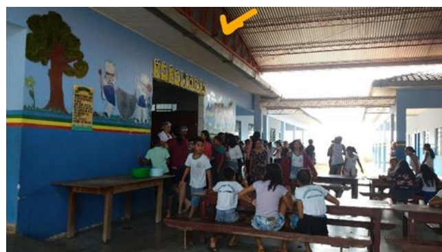
Foto 82 - Pombos acima da janela da cozinha e do refeitório da merenda escolar, contrariando o Item 4.1.7 da Resolução-RDC Anvisa 216/2004. - Data: 18/12/2018
