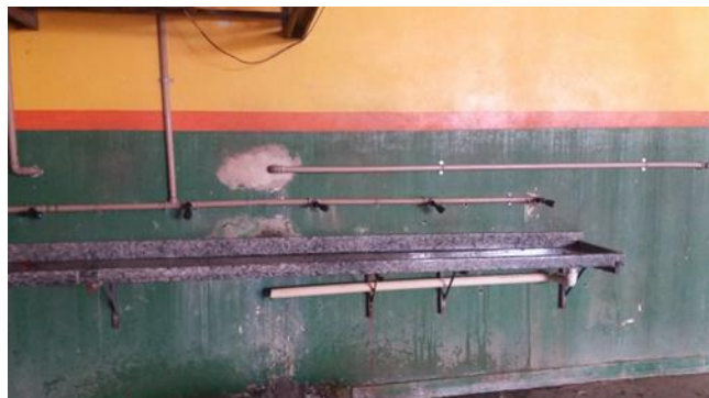
Foto 60 - Bebedores / Lavatórios em péssimo estado de conservação. Data: 27/09/2017
