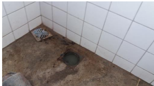
Foto 56 - Banheiro inativo na divisa do refeitório apresentando agentes contaminantes. Data: 22/09/2017
