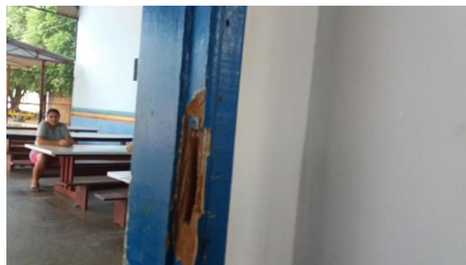
Foto 22 - Portal com defeito, possibilitando acidentes, juntar sujeira, acúmulo de sujeira, contrariando o item 4.1.3 e 4.1.4 da Resolução-RDC Anvisa 216/2004 Data: 22/09/2017
