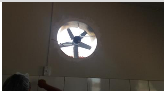
Foto 32 - Exaustor com defeito - Barulho Excessivo fato que impossibilita o uso e ausência de tela milimétrica, contrariando os itens 4.1.4, 4.1.10 e 4.1.11 da Resolução-RDC Anvisa 216/2004 - Data 25/09/2017
