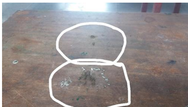
Foto 74 - Fezes de pombos sobre a mesa onde é servida a merenda escolar, contrariando o Item 4.1.7 da Resolução-RDC Anvisa 216/2004. - Data: 18/12/2017
