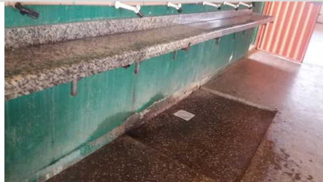
Foto 59 - Bebedores / Lavatórios em péssimo estado de conservação. Data: 27/09/2017
