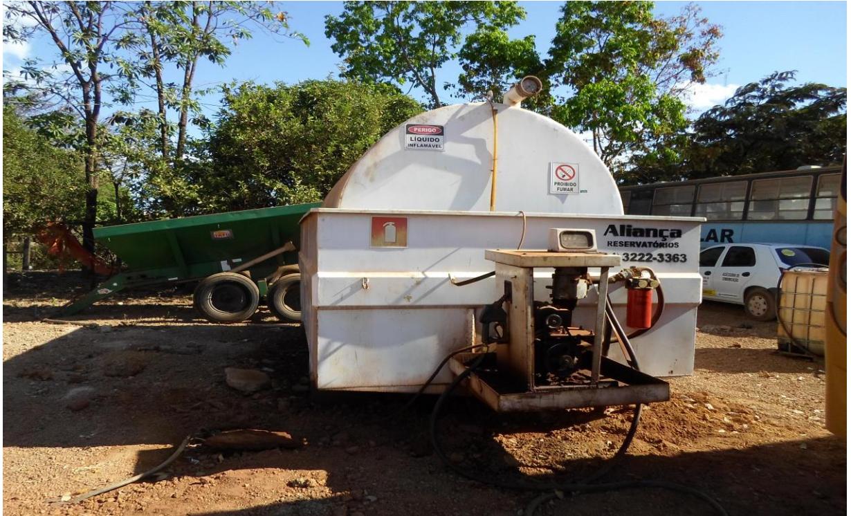
Foto 054 - Ponto de abastecimento sem cobertura – Pátio de Maquinas – Distrito União do Norte – Peixoto de Azevedo MT
