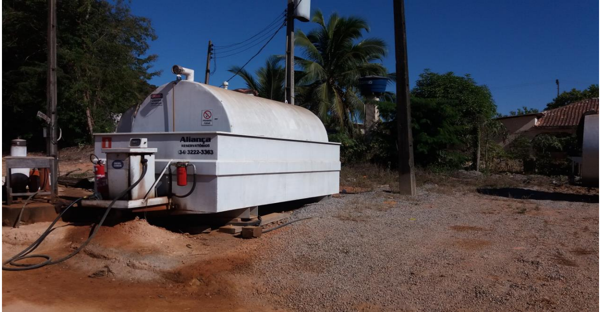
Foto 048 - Ponto de abastecimento sem cobertura – Pátio de Maquinas – Z. Urbna – Peixoto de Azevedo MT
