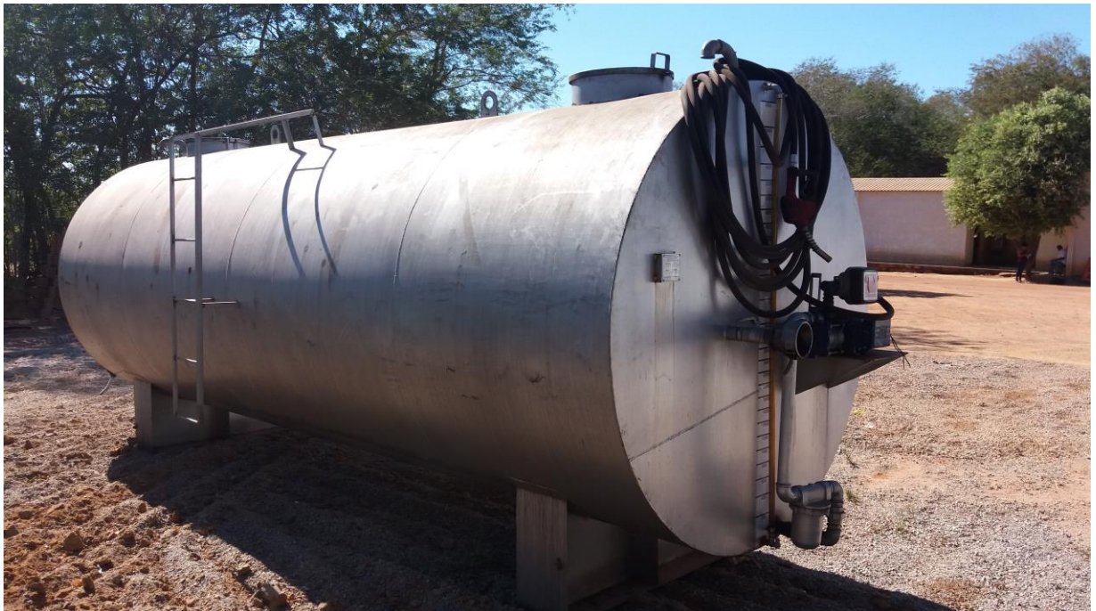
Foto 051 - Ponto de abastecimento sem cobertura – Pátio de Maquinas – Z. Urbna – Peixoto de Azevedo MT
