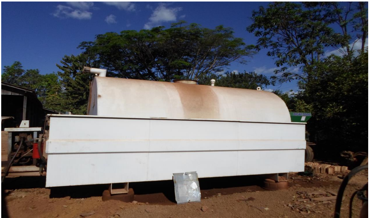
Foto 055 - Ponto de abastecimento sem cobertura – Pátio de Maquinas – Distrito União do Norte – Peixoto de Azevedo MT
