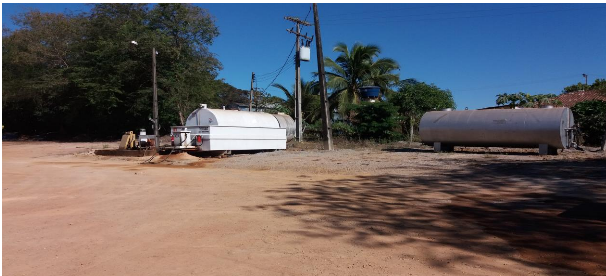
Foto 061 - Ponto de abastecimento próximo a transformador de energia elétrica – Pátio de Máquinas – Peixoto de Azevedo MT.
